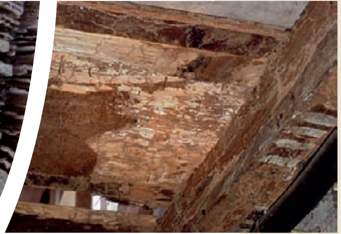
Attaques sur un solivage de plancher
