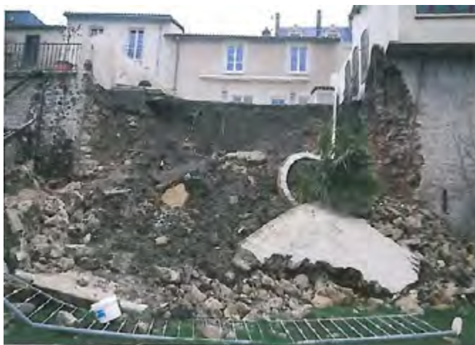
Vue du mouvement de terrain Source BRGM avril 2013
