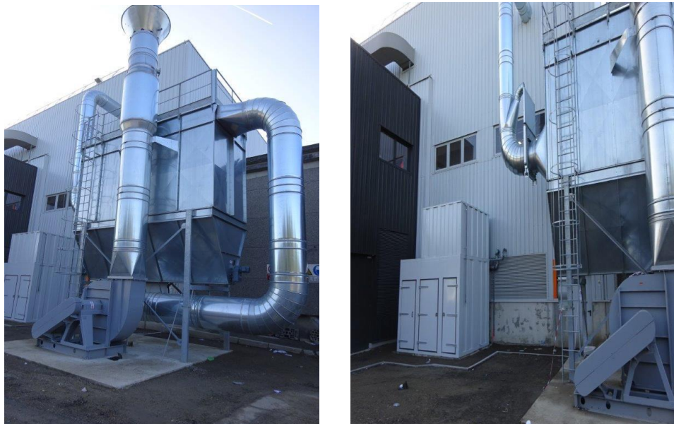
Figure 34 – Centrale de dépoussiérage. A droite, un focus sur la guillotine à commande pneumatique
