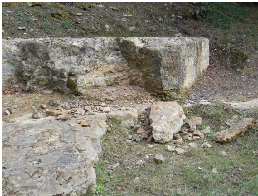
Figure 48. Dégradation de l'ensemble « banc lumateux – banc de gailletière » sur le site n°2 de la réserve naturelle durant les Journées européennes du patrimoine en septembre 2016.
